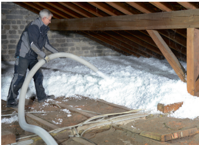
Die neuen, nichtbrennbaren Mineralwolle-Flocken aus reiner Glaswolle werden einfach über einen Schlauch auf die oberste Geschossdecke geblasen.
