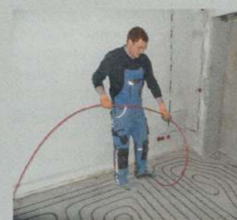
2 Wir wählen ein System, das keinen zusätzlichen Fußbodenaufbau benötigte, da die Leitungen in passend gefrästen Rohrkanälen ...
