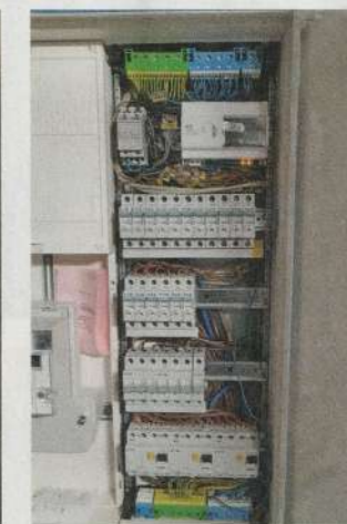
7 Im neuen Sicherungskasten gibt es normale Sicherungen und Sicherheits-FI-Schalter, die bei einem Fehlerstrom die Anlage blitzschnell abschalten.
