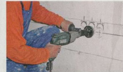
2 Für die Unterputz-Leerdosen mit einer Bohrkronen alle Hohlräume für Schalter und Steckdosen aus den Wänden herausfräsen.
