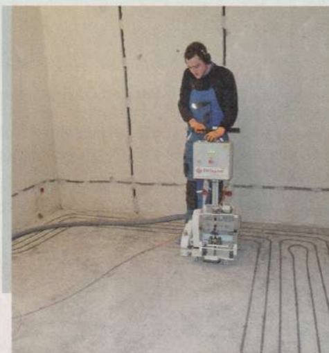
1 Eine Fußbodenheizung ist beim klimaneutralen Gebäude eine sinnvolle Lösung. Aufgrund der großen Flächen kann die Vorlauftemperatur der Heizung deutlich niedriger als bei Heizkörpern eingestellt werden. Das spart Energie.
