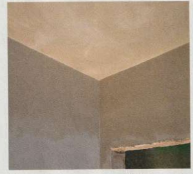
3 Ist der alte Putz insgesamt noch in Ordnung? Dann reicht eine dünne Spachtelschicht. Dabei an der Decke beginnen, nach unten arbeiten.
