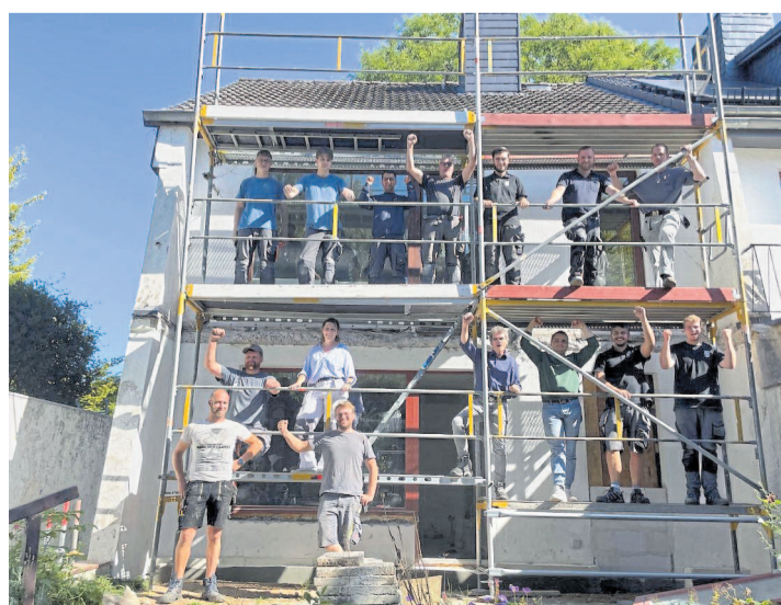
Insgesamt rund 60 Handwerkerinnen und Handwerker waren auf der Baustelle beschäftigt – trotzdem konnte gespart werden.
