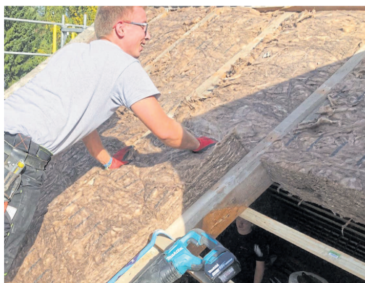
Die Regierung lässt von strengen Dämm-Vorgaben ab – Meyer will darauf aber auf keinen Fall verzichten.
