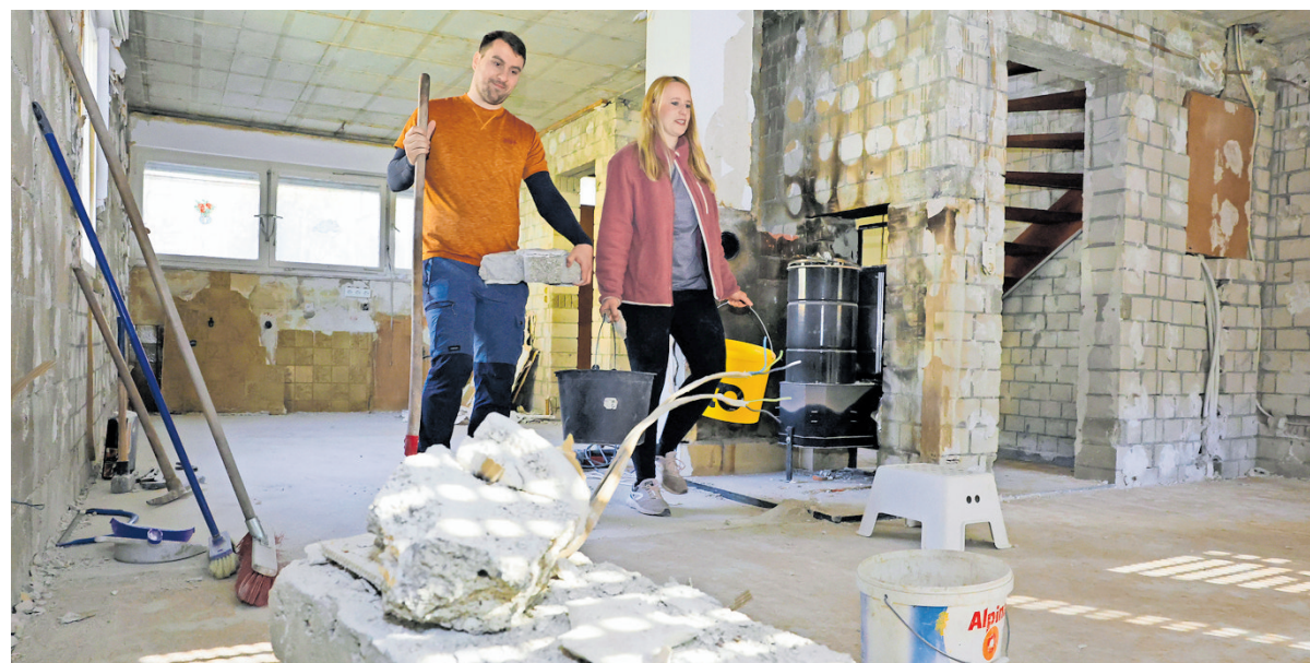
Bei der Entkernung durften die Bauherren selbst ran. Start des Sanierungssprints ist der 10. April.
