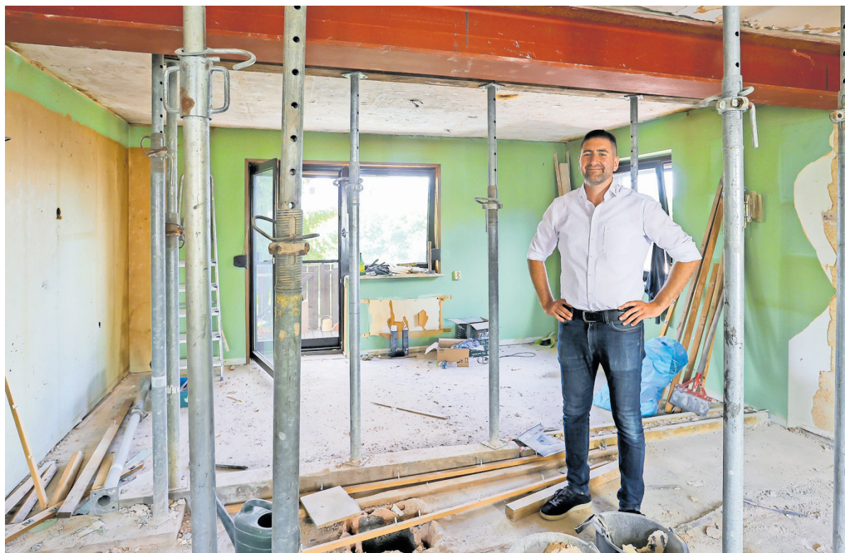
Bauphysiker und Energieberater Maximilian Chamaoun in einem Haus, das sich in der Entkernung befindet. Ist das Haus von Altlasten befreit, könnte der Sanierungssprint beginnen. Fotos: Oliver Bürkle
