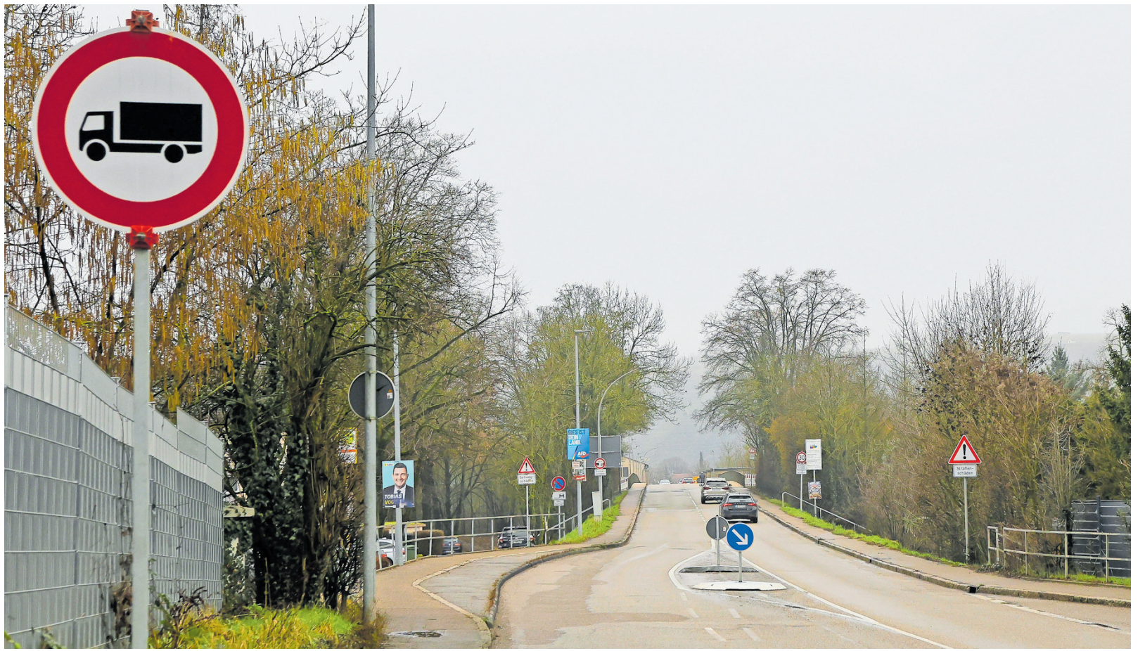
Seit Februar sind die Neckarbrücken in Besigheim für Lkw gesperrt. Nach Aussagen des Regierungspräsidiums sollen die Bauwerke noch vier Jahre halten, bevor sie saniert beziehungsweise neu gebaut werden. Der Zustand der Brücken macht zunehmend Sorgen in sechs Kommunen, die bei einer möglichen Sofortsperre ein Verkehrschaos erwarten. Foto: Oliver Bürkle
