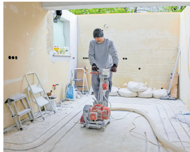
Blick in die künftige Küche im Erdgeschoss: Hier werden die Schlitzte für die Heizschlangen der Fußbodenheizung gefräst. Fotos: Martin Kalb
